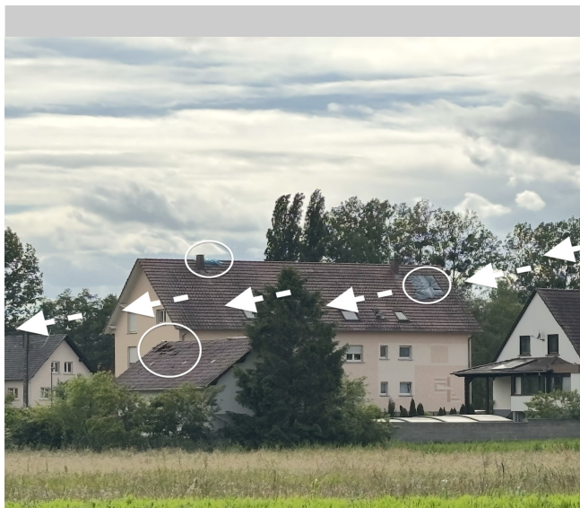
4. Toitures très partiellement détuilées. Il est intéressant de noter que les parties détuilées se situent sur les versants de toits opposés au déplacement de la tornade. Celle-ci arrivant en effet par les grands arbres au fond à droite (photo : Christophe Mertz/ATMO-RISK).
