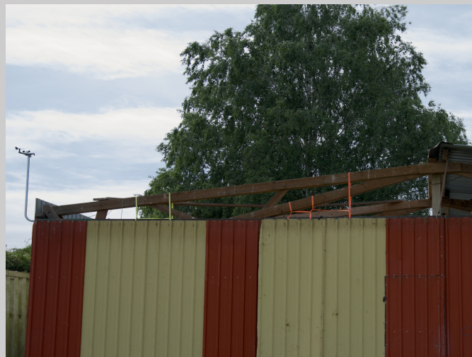
7. Toiture arrachée du hangar de l'ULM club Wissembourg. Une station météo à enregistrement automatique est visible à gauche. Les éventuelles données vent enregistrées par l'anémomètre sont en cours d'étude (photo : Christophe Mertz/ATMO-RISK).
