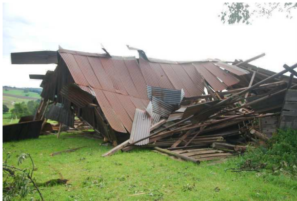
Hangar agricole effondré sur lui-même, Eschwiller. On remarque que la structure s'est légèrement déportée avant de s'écrouler. Les dommages sont ici d'intensité EF 1. Le hangar se trouve dans la partie la plus touchée du village, au cœur de la trajectoire de la tornade.
